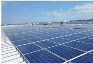
▲太陽光発電所のパネル（旭食品 神戸支店）
